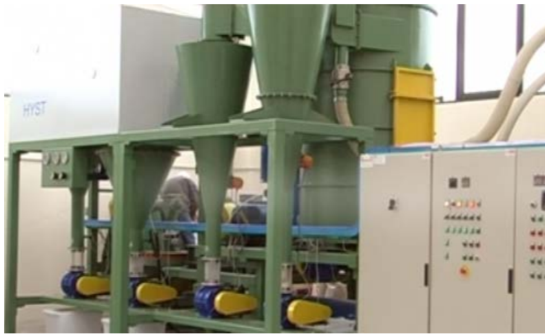
L'impianto per la trasformazione delle fibre vegetali in farine alimentari
